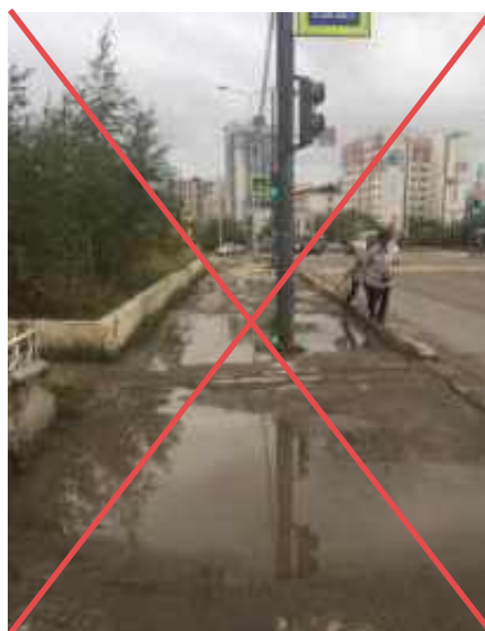
Плохо. Дорожные столбы расположены в транзитной зоне и преграждают путь пешеходам
