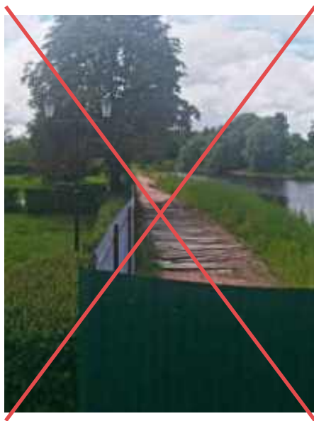
Плохо. Внешний вид глухого временного ограждения стройплощадки из профлиста снижает уровень проницаемости городской среды
